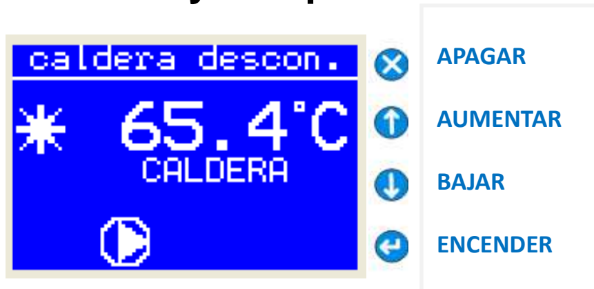
Figura 7. Aspecto de panel de control
